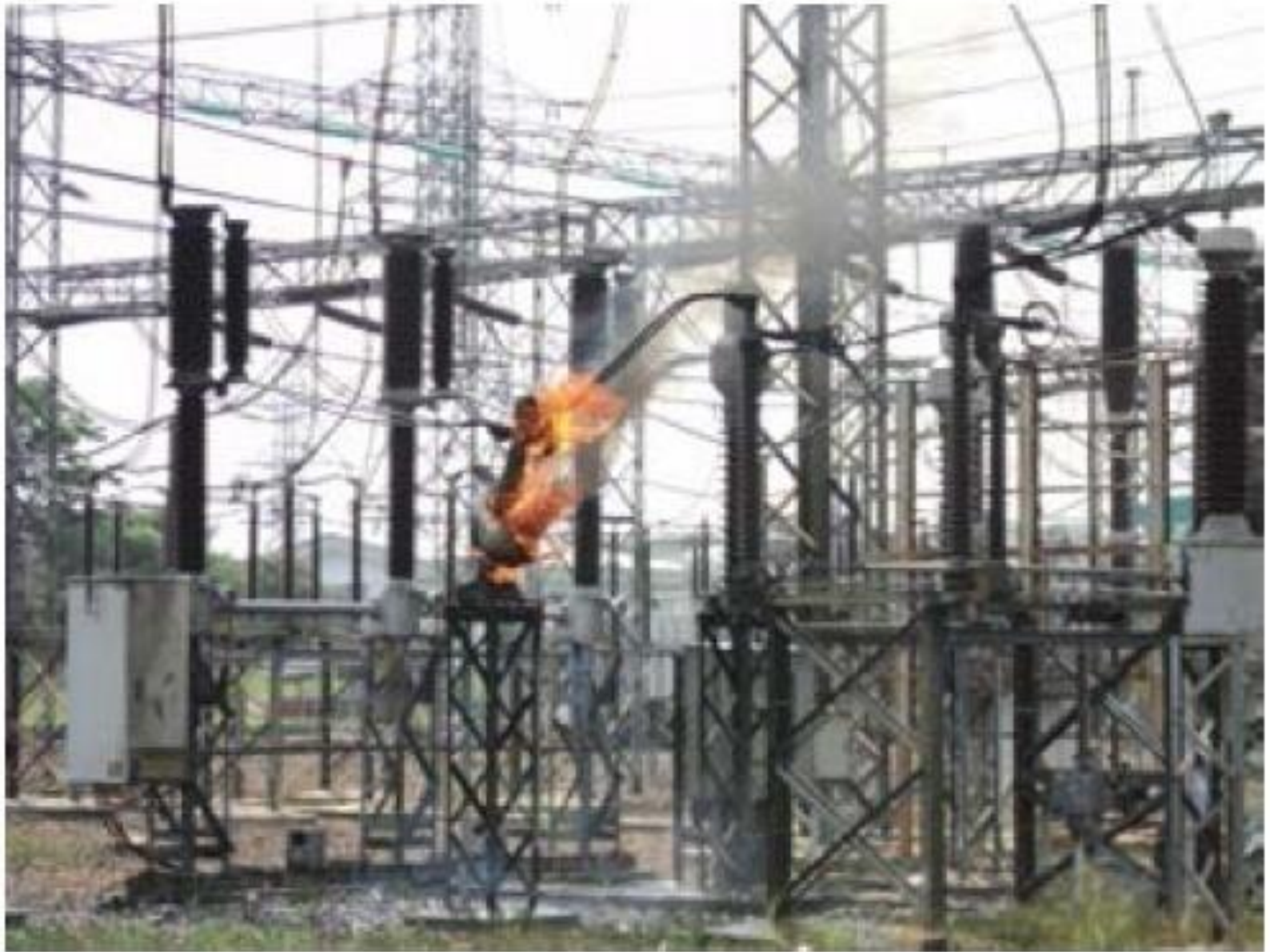
Gambar. 2 CT IBT 1 500/150kV Sisi 150 KV Phasa R Terbakar
